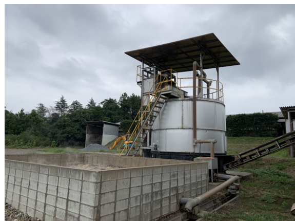
(写真7) 縦型コンポストと脱臭槽
